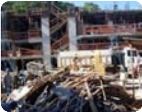
Figura 7: Segregação da madeira no Canteiro de Obras
